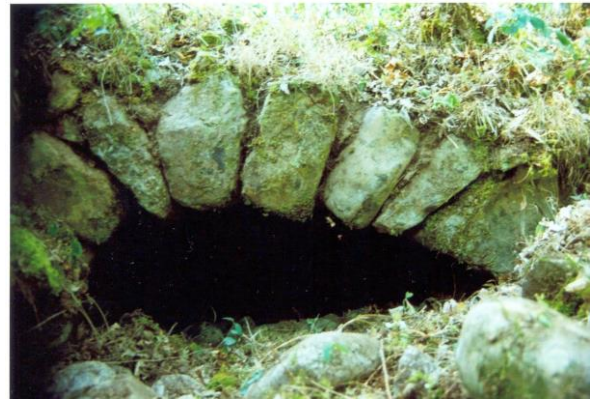
Canal de conducción de agua
